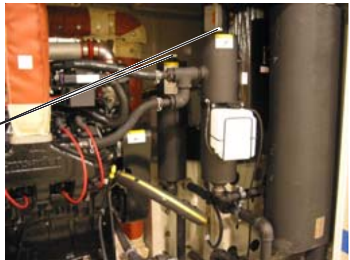
Coolant Fill Caps
